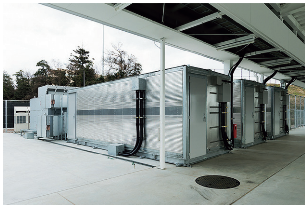
写真2 松江データセンターパーク
