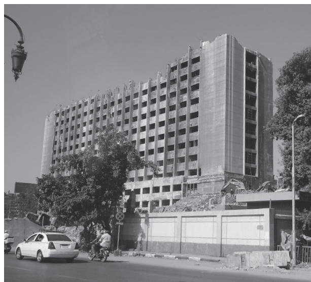
当時の与党、国民民主党（NDP）本部跡：アラブの春の際に焼き払われたままとなっていたが、今年、解体が開始された。
